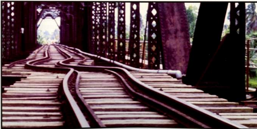
Deformación de varios puentes ferroviarios fue otro efecto del terremoto. Foto: Sergio Paniagua.
