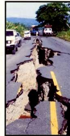
Daño en la carretera Siquirres-Limón. Foto: Sergio Paniagua.
