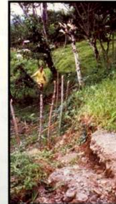
La falla Río Blanco se movió durante el terremoto y produjo el escarpe de 1,5 m que se observa.
